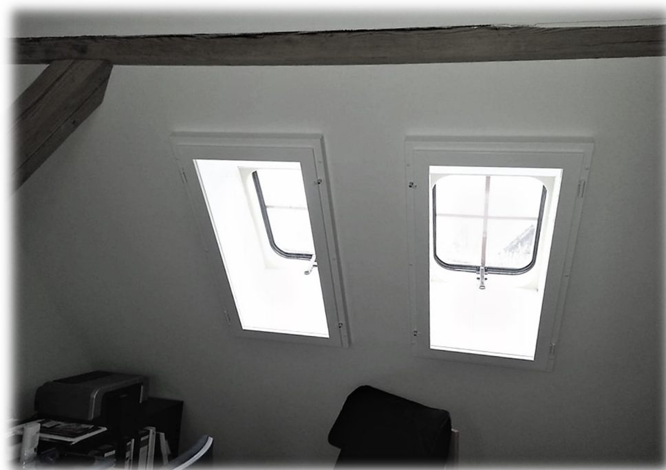
Thermo-Dachfenster mit einer nachträglich angebrachten Innenverglasung zur Minimierung von Kondensatbildung
