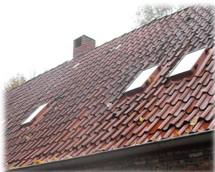
Passgenaue Stahldachfenster (hier in einer mit Hohlziegeln eingedeckten Dachfläche)
